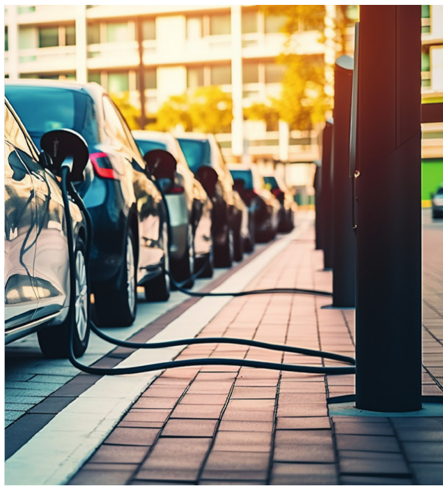
Carga de vehículos eléctricos.
